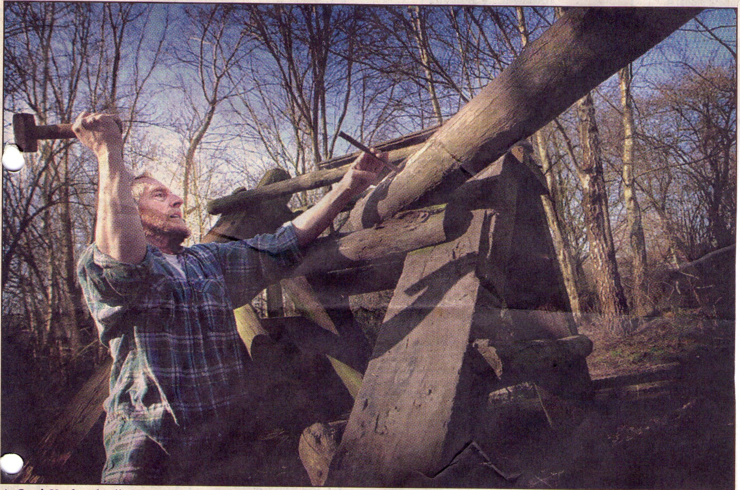
▲ Gerrit Vos breekt zijn levenswerk Le Roy gedeeltelijk af. „Dat Attractiebesluit gaat uit van veiligheid voor kinderen van drie jaar. Die komen hier dus niet.”
