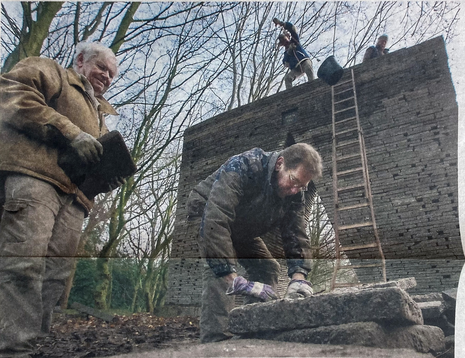
MILDAM In de Ekokathedraal van Louis le Roy in Mildam leggen vier mannen de laatste hand aan de hemelpoort, de 'Porta Celi'. Het kunstwerk is opgebouwd uit 7500 stoeptegels. De mannen werkten er een jaar aan. Op de foto pakken Johan van der Zee en Rob Theel de laatste tegels. Bovenop de
